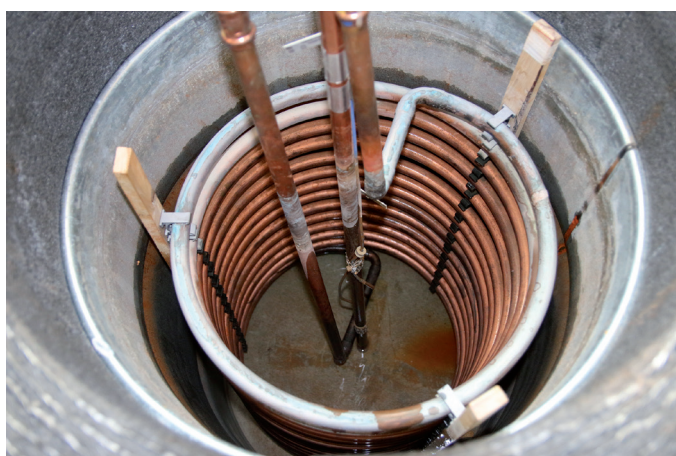
Obr. 5 Výměník tepla v odpadní jímce
