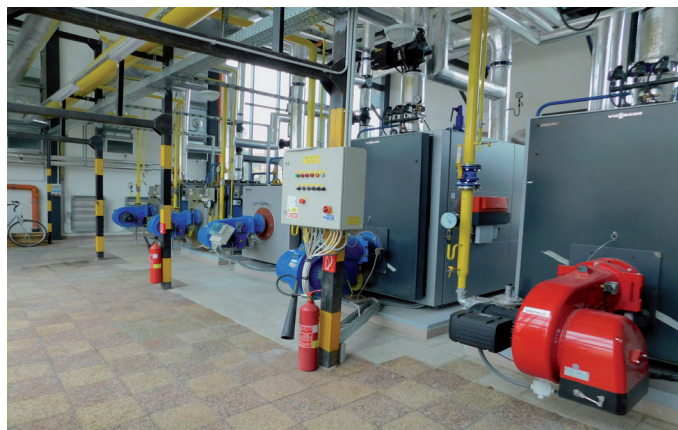
Obr. 6 Pohľad do zrekonštruovanej teplovodnej kotolne na zemný plyn Fig. 6 View to the reconstructed hot-water boiler house for natural gas
