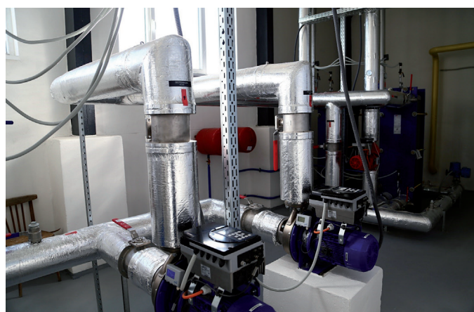
Obr. 5 Pohľad na doskové výmenníky tepla VT1 a VT2 s obehovými čerpadlami v popredí
