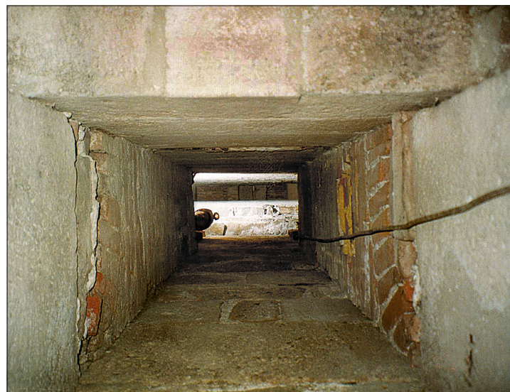
Obr. 11 Větrací komín vedoucí z prevetové šachtice
