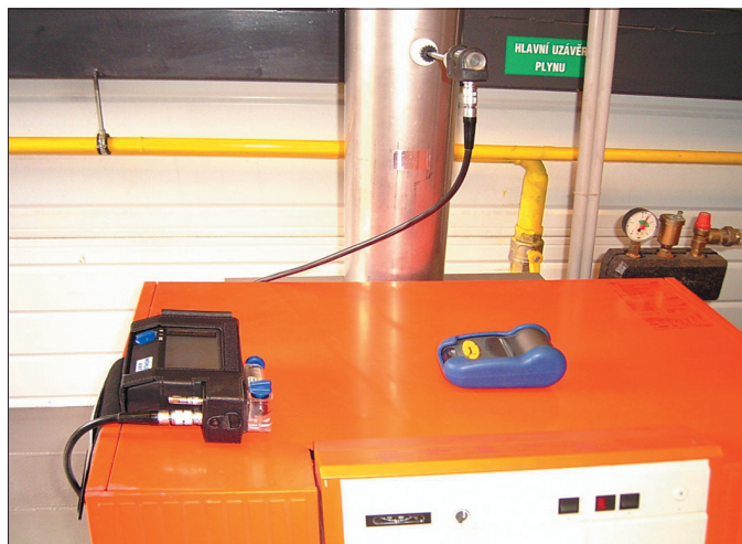
Obr. 1 – Měřící otvor u kotle s atmosférickým hořákem a přerušovačem tahu
