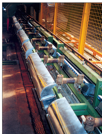
Obr. 5 – Výfukové štěrbin instalované v chladicí zóně válečkové tratě
