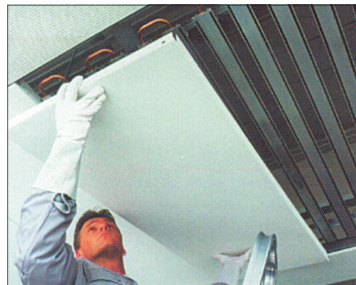
Obr. 6 – Uzavřený chladicí strop
