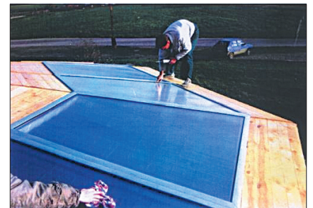
Obr. 2 – Solární kolektory montované jako součást střechy oktagonálního domku (se svolením firmy Eko-solaris)
