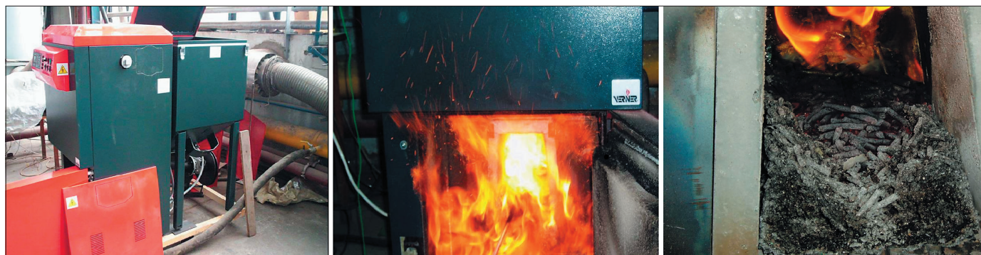
Obr. 8 Spalovací zařízení – kotel VERNER A 25
