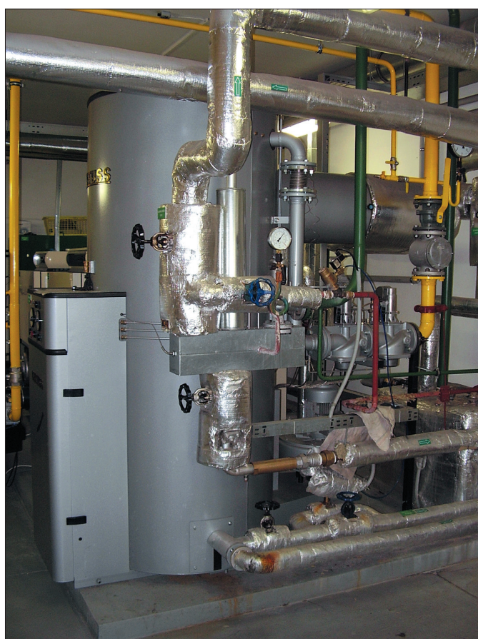
Obr. 4 Kotelna K I parní vyvíječ
