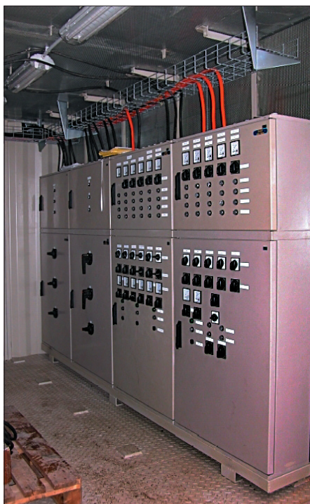
Obr. 18 Kontejner s elektrickými rozvaděči
