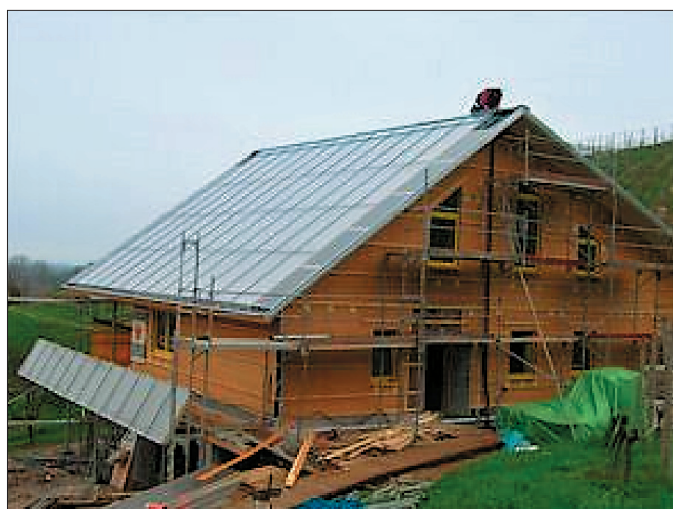
Obr. 10 Solární kolektory na střeše a zábradlí terasy (RD Kappelrodeck)
