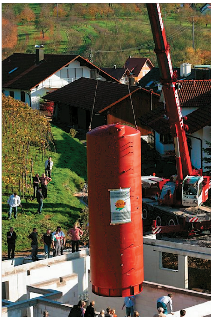
Obr. 9 Instalace zásobníku do centrální dispozice domu (RD Kappelrodeck)
