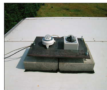
Obr. 18 Pyranometry na střeše objektu, Wilhelm Lambrecht nalevo a BF3 napravo
