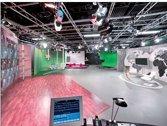
Obr. 12 Použití otevřených chladicího stropů v televizním studiu [3]
