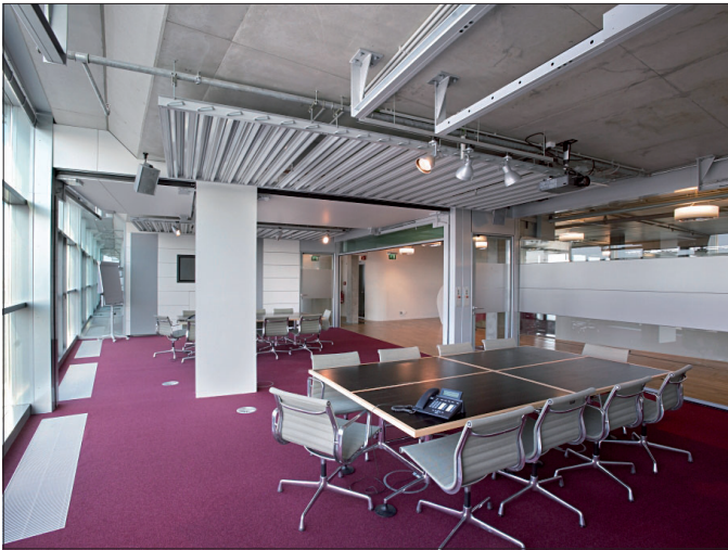
Obr. 11 Ukázka viditelného chladicího stropu v zasedací místnosti [3]
