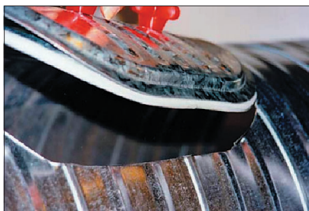
Obr. 7 Vstupní otvor pro čistícího robota
