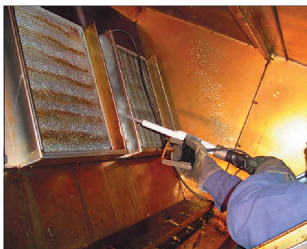
Obr. 13 Čištění digestoře pistolí
