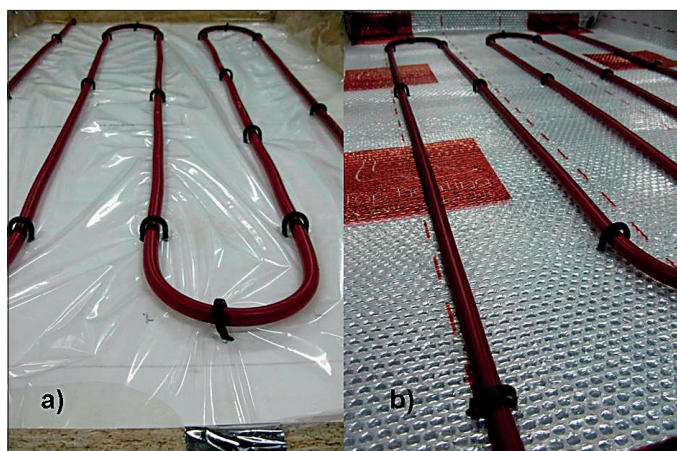
Obr. 3 Detail upevnění otopného hadu plastovými sponami vlevo – PE fólie; vpravo – termoreflexní fólie
