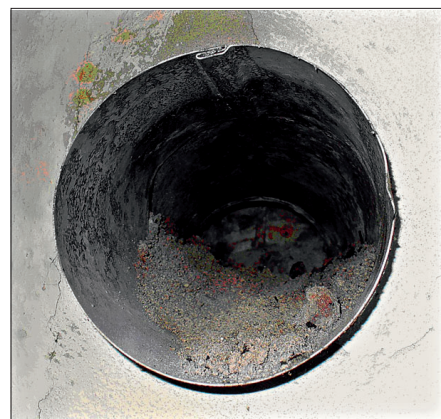
Obr. 2 Jiný příklad zanesené kondenzátní jímky a sopouchu spotřebiče na plyné palivo v koupelně se stejným výsledkem, tedy s otravou CO uživatele spotřebiče paliv
