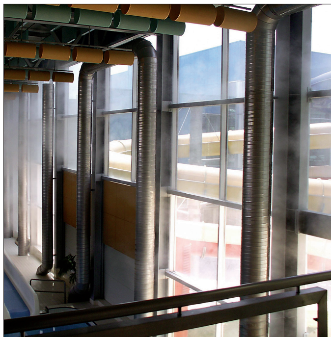
Obr. 3 Vzduch je na vysoká okna úspěšně přiváděn z vertikálního potrubí
