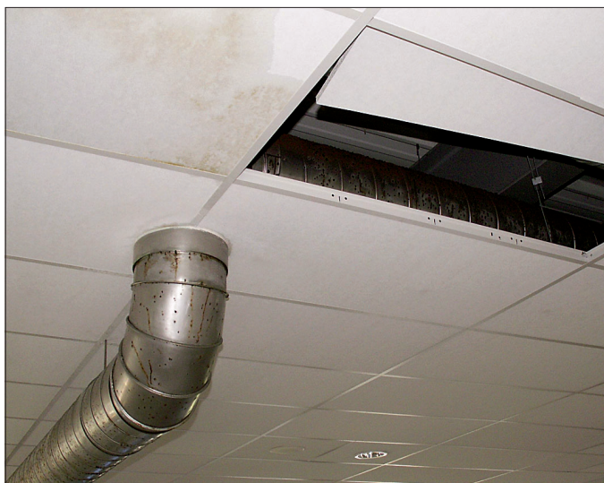
Obr. 2 Nerezové potrubí pro odvod vzduchu je proděravělé intenzivní korozí
