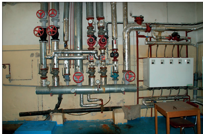
Obr. 1 Kotelna s původními rozvody, novými elektrokotlí a čerpadly
