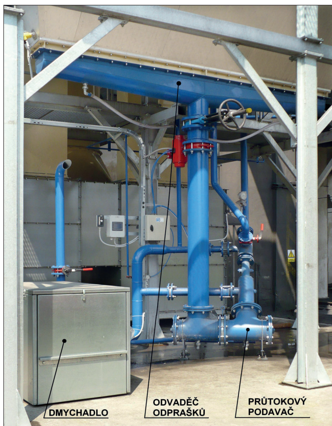
Obr. 2 Zařízení pro odsun odprašků FLOW-OFF – celkový pohled
