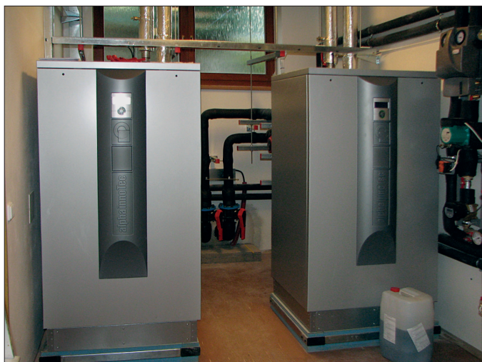
Obr. 1 Kotelna s tepelnými čerpadly
