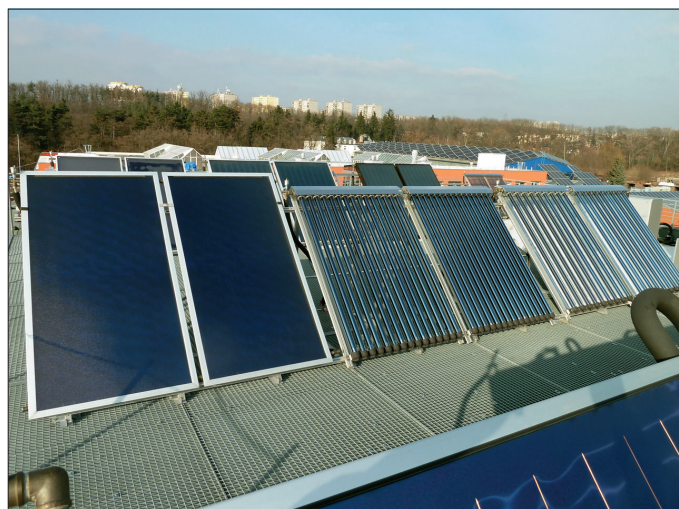
Obr. 5 Kolektorové pole na střeše administrativního a zkušebního objektu
