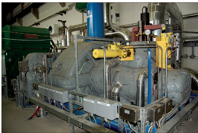
Obr. 5 Foto instalované turbíny TG3
