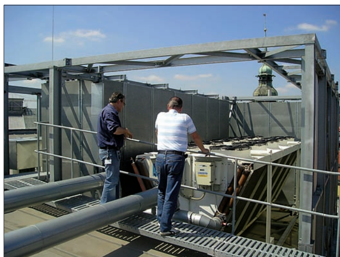
Obr. 3 Společný glykolový výměník na střeše
