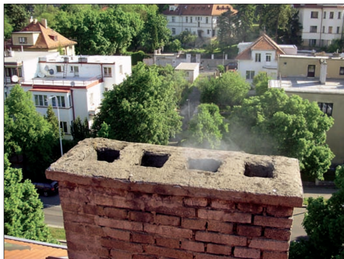
Obr. 1 Výdech z digestoře na střeše
