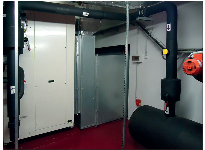
Obr. 1 Fragment strojovny chlazení (chladicí jednotka s detailem sání vzduchu)
