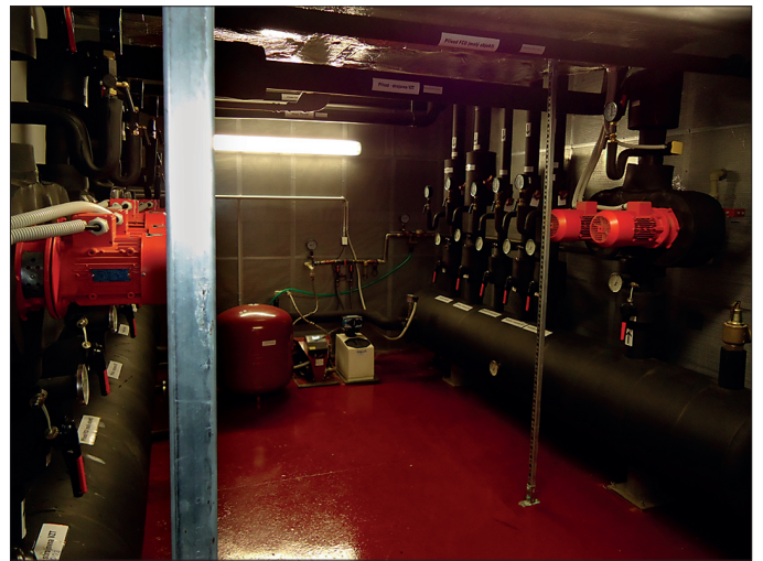
Obr. 2 Fragment strojovny chlazení (instalace sběrače a rozdělovače)
