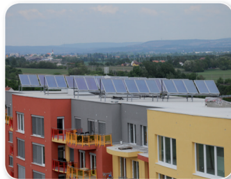
Solární systém na bytovém domě v Rajhradě
