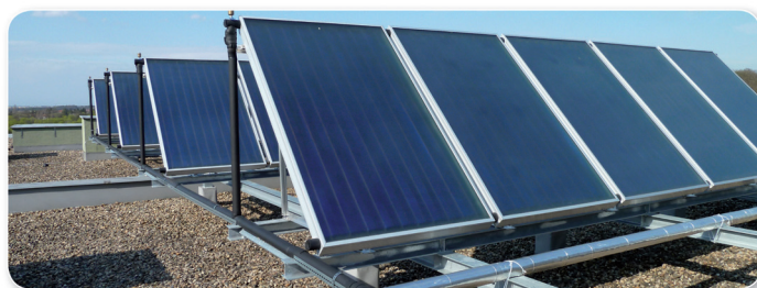
Solární systém na bytovém domě v Praze
