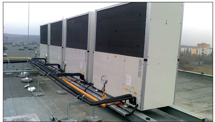
Obr. 7 Sústredené osadenie štyroch tepelných čerpadiel na plochej streche bytového domu
