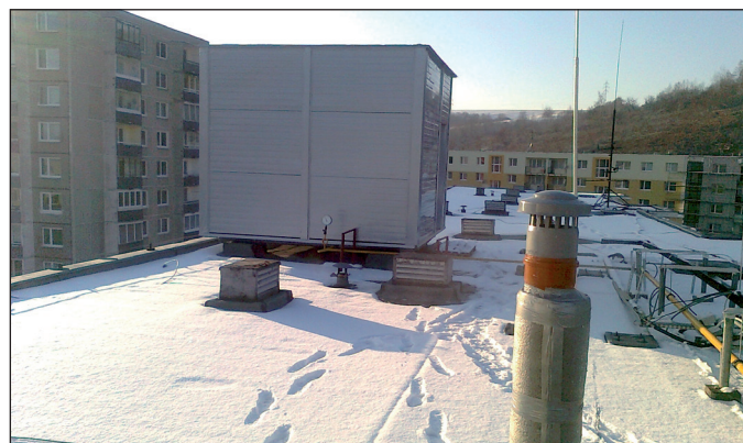
Obr. 3 Decentrálne, zdroje na výrobu tepla – tepelné čerpadlá na plochej streche
