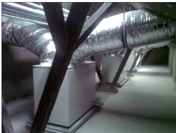
Obr. 1 Decentrálne, blokové zdroje na výrobu tepla – tepelné čerpadlá v podkrovi
