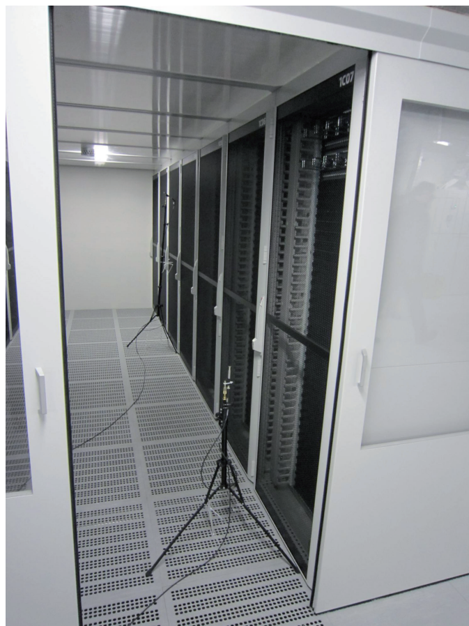
Obr. 5 Umístění mikrofonů v uličce mezi RACKy (měřicí místo č. 2 a 3, měření č. 2)
