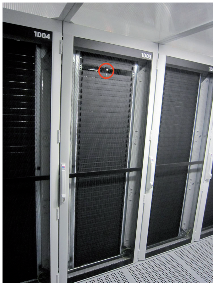
Obr. 6 Umístění mikrofonů přímo v RACKu (měřicí místo č. 4, měření č. 2)
