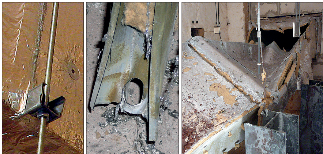
Obr. 6 Vlevo závěs bez podložky pod maticí a na dalších obrázcích možný důsledek – uprostřed patrné rozšíření otvoru v nekvalitní závěsné liště, vpravo pád vzduchovodu po 20minutovém působení požáru
