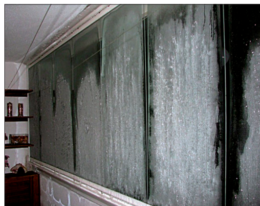
Obr. 2 Příklad nedostatečného větrání lodžie
