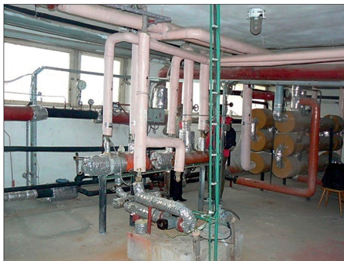
Obr. 9 Pohľad na odovzdávaciu stanicu tepla [6]
