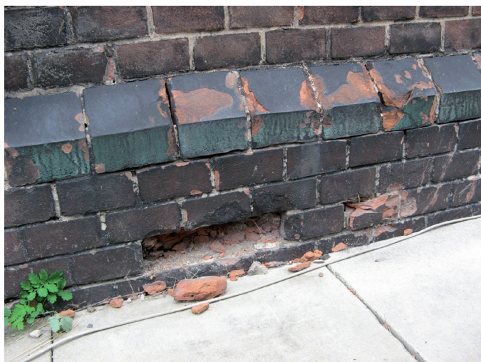
Obr. 8 Degradace keramického obkladu Fig. 8 Degradation of the ceramic wall tiling
