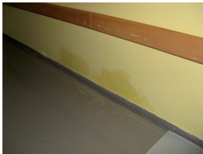
Obr. 9 Viditelná vlhkost v interiéru Fig. 9 Visible humidity in the interior
