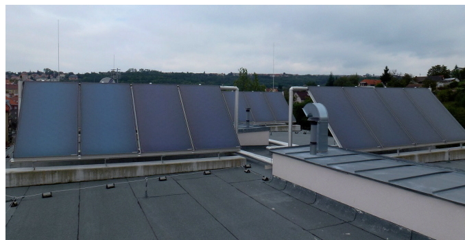
Obr. 3 Kolektorová pole solární soustavy na střeše bytového domu
