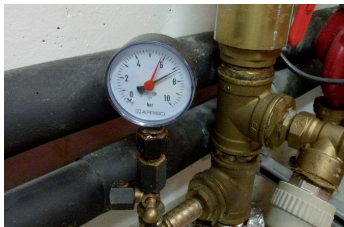
Obr. 8 Trvalé tlakové poměry na zásobníku s max. přetlakem 6 bar a jeho jištění Fig. 8 Permanent pressure ratios on the storage tank with max. overpressure 6 bar and its protection
