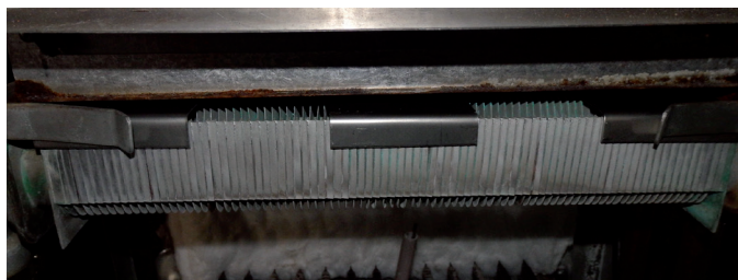
Obr. 6 Ucpávání výměníku kotle (zakrytí 60 %) Fig. 6 Clogging of the boiler heat exchanger (60% coverage)
