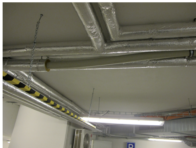
Obr. 5 Prověšení plastového potrubí po uvedení do provozu v důsledku absence kompenzátorů a kluzných bodů uchycení
