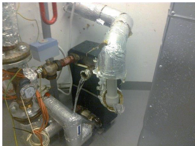
Obr. 7 Stav výměníku teplé vody těsně po havárii
