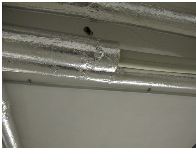
Obr. 4 Ukázka porušení uchycení pevného bodu potrubí a narušení stropní konstrukce vlivem teplotní délkové roztažnosti potrubí
