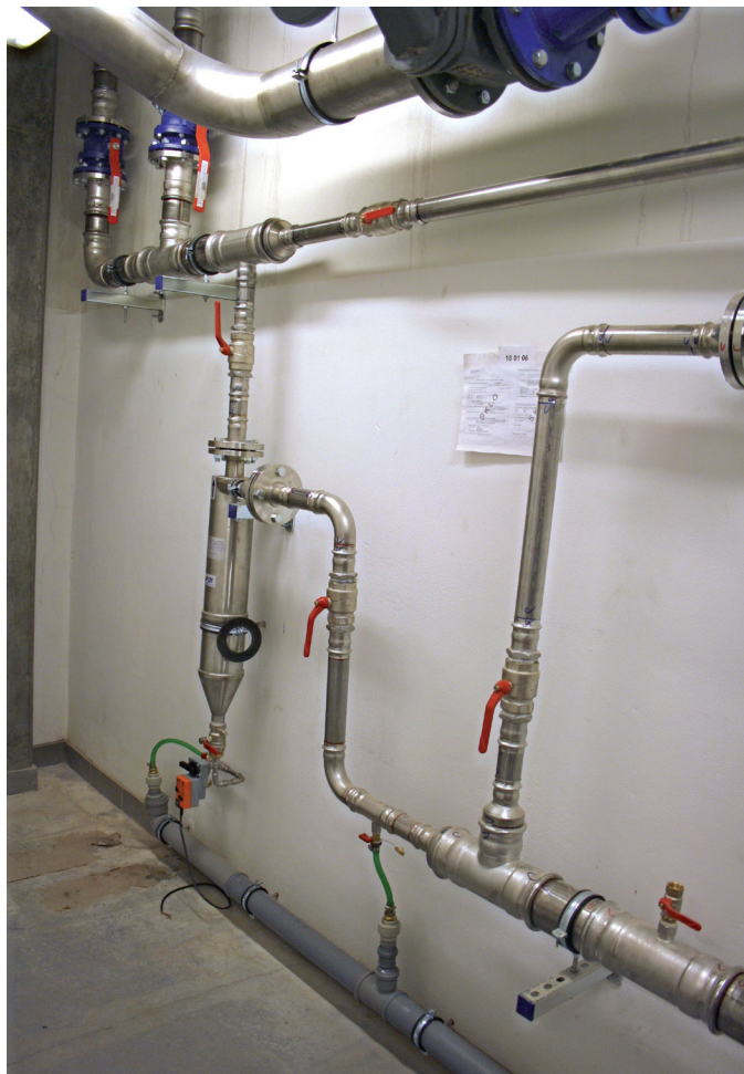
Obr. 7 Odstředivý lapač kalu na přípojce studené vody
