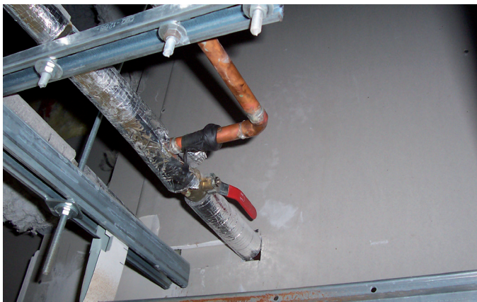
Obr. 6 Důlková koroze měděného cirkulačního potrubí
