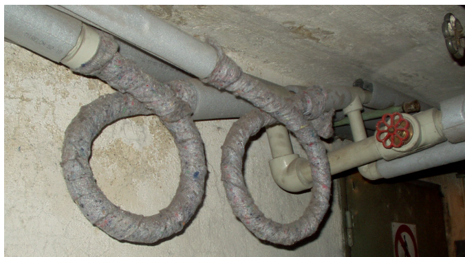
Obr. 3 „Kompenzační smyčka“ na vodorovném potrubí ve sklepě
