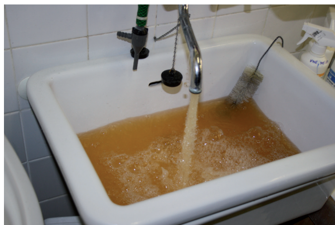
Obr. 1 Ranní „proplachování“ ocelového pozinkovaného potrubí
