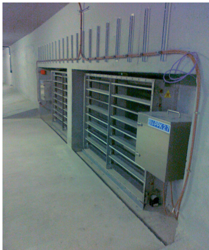
Obr. 5 Řídicím systémem dálkově ovládaná klapka, která je v zaústění každého ze svodů odvodu kouře do požárního větracího kanálu pod vozovkou
