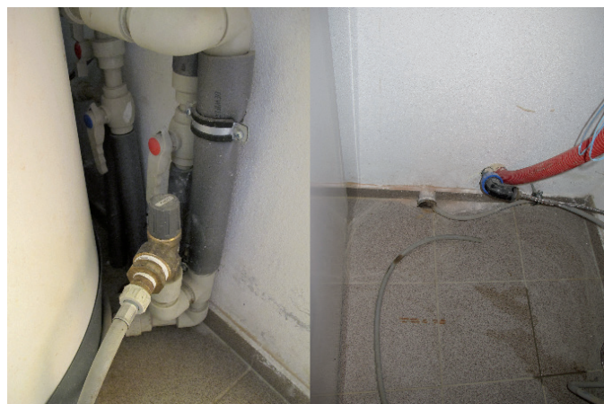
Obr. 4 Příklad nedodržení zásad instalace odtokového potrubí u pojistného ventilu zásobníku teplé vody
