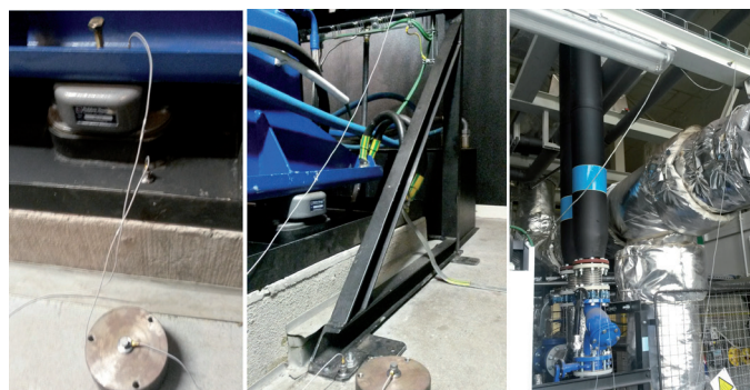
Obr. 7 Meracie miesta na kogeneračnej jednotke: (vľavo) silentblok, (v strede) podperný rám potrubnej sústavy, (vpravo) vlnovec v potrubí chladiacej vody
