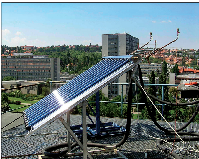
Obr. 2 Výzkum a vývoj solárních kolektorů
