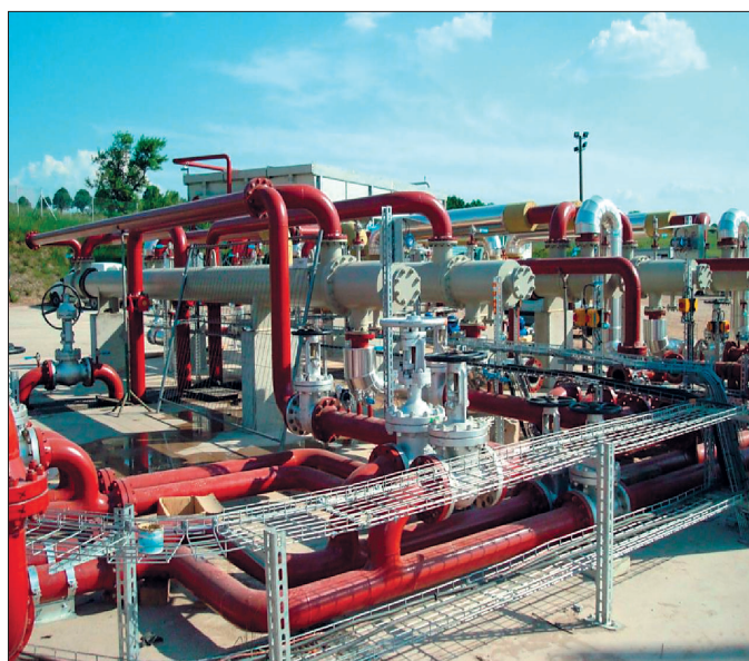
Obr. 3 Část rozvodu čerpané vstupní a výstupní ohřívané vody
