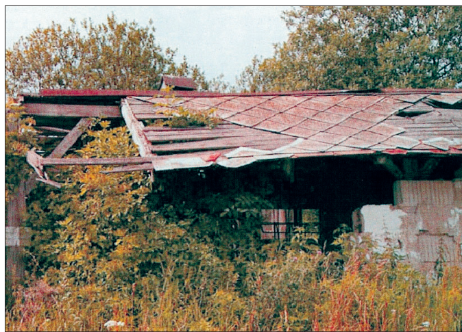
Obr.1. Azbestocementová střešní krytina
