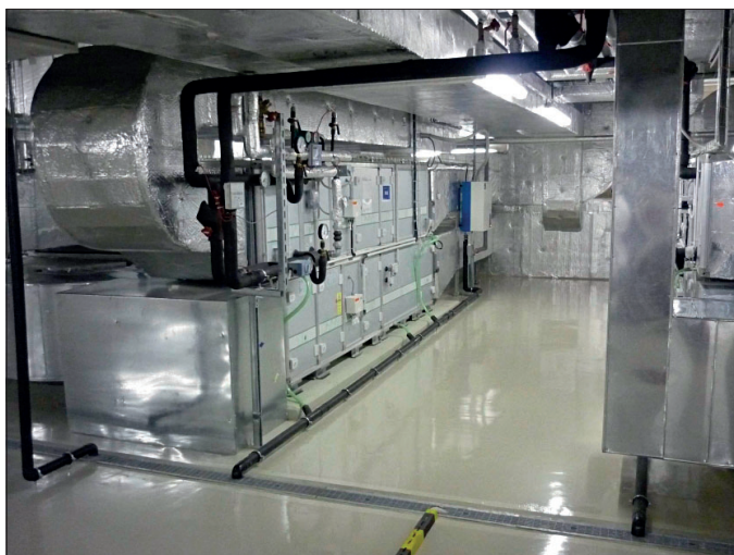
Obr. 7 VZT jednotka ve strojovně vzduchotechniky
