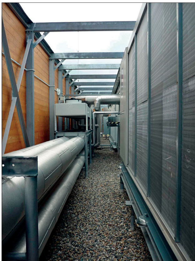
Obr. 5 Na střeše jsou chladicí a VZT zařízení umístěna za akustickými stěnami.
