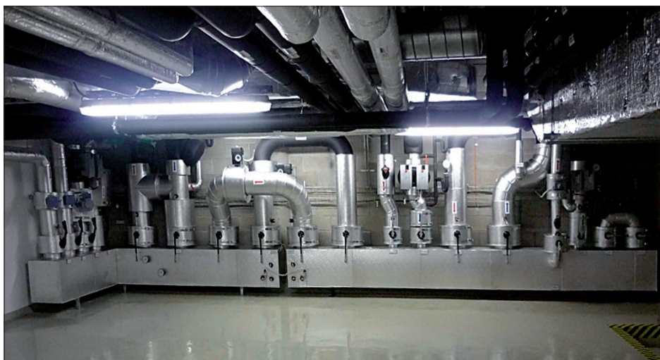
Obr. 3 Vlevo kombinovaný rozdělovač, vpravo rozdělovač chlazení. Oba umístěné ve strojovně VZT.
