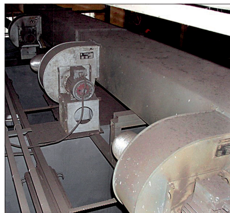
Obr. 5 Odsávací systém so samostatnými ventilátormi
