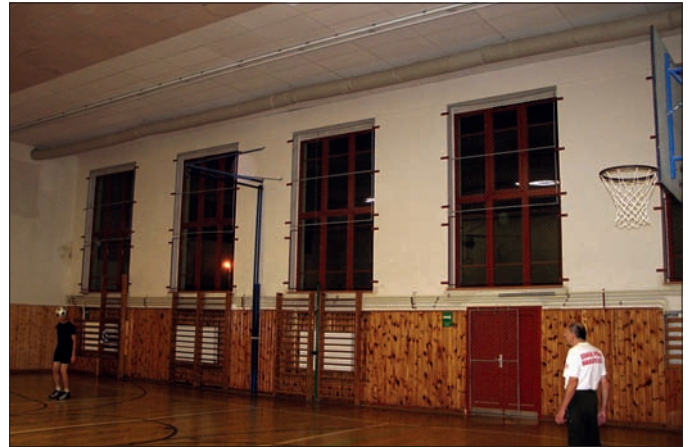
Obr. 3 Textilní vyústka je vedená nad okny (1,3 m od oken), přívod vzduchu je směřován šikmo vzhůru do prostoru
