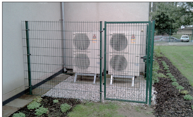
Obr. 3 Umístění chladicích jednotek ve venkovním prostředí
