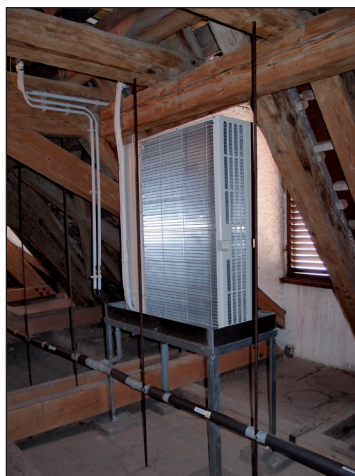
Obr. 6 Umístění výkonově menší chladicí jednotky v půdním prostoru
