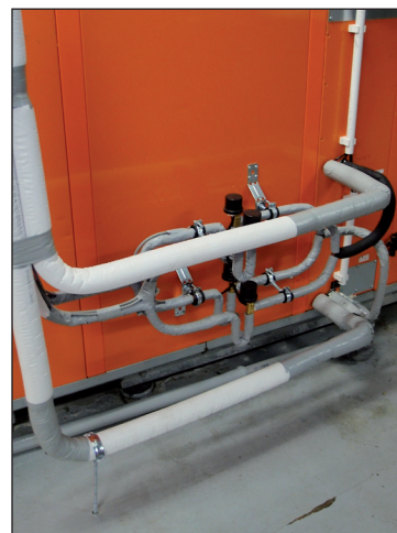
Obr. 7 Detail expanzních ventilů u VZT jednotky – dvouokruhový výměník
