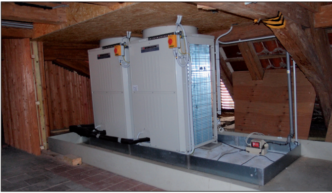
Obr. 5 Umístění venkovních chladicích jednotek v půdním prostoru
