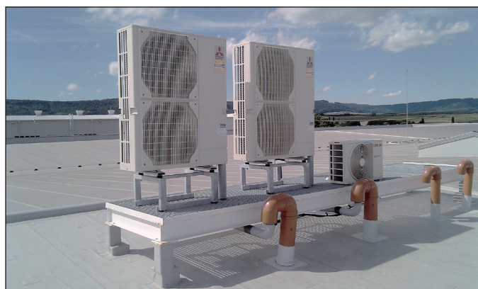
Obr. 4 Umístění chladicích jednotek na střechu objektu
