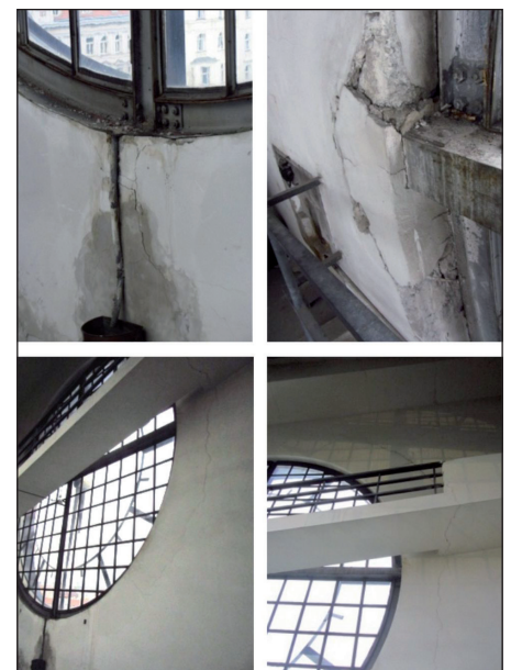
Obr. 4 Interiér: viditelné poškození [7]
