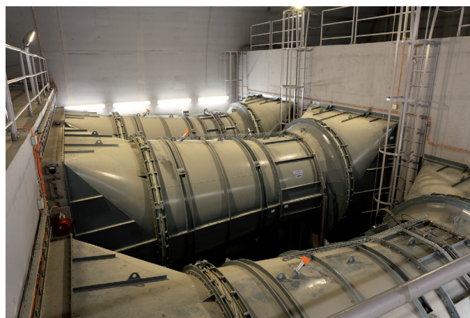
Obr. 2 Nahoře: Proudové ventilátory v tunelu Blanka jsou umístovány obvykle po dvojicích nebo trojicích u stropu tunelu. Dole: Trojice axiálních ventilátorů ve strojovně vzduchotechniky, součást příčného systému větrání [2]
