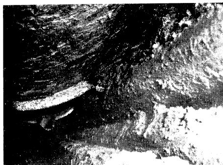
Obr. 2. Pohled do vnitřního prostoru kotle po demontáži kotlové trubky. Usazeniny jsou zcela evidentní.
