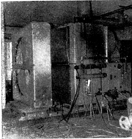
Obr. 3. Pohled na rotační regenerační výměník napojený na trať
